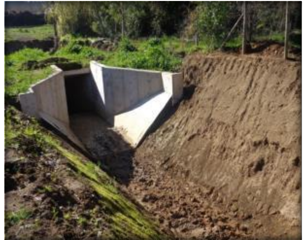
Cámara de salida de Sifón Fortaleza.
